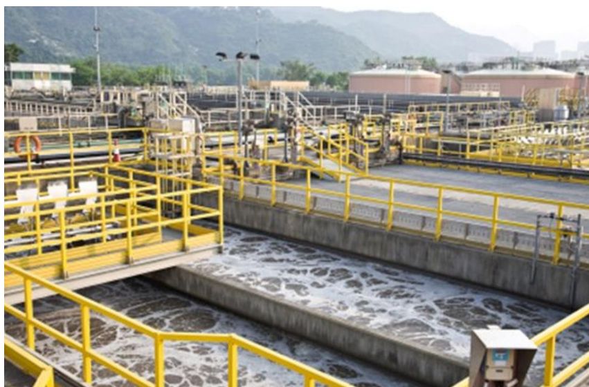
Figura 3-5 Estación de fangos activos [24]
