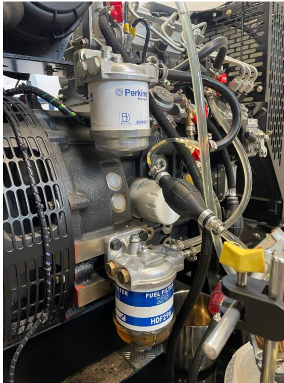
Figura 3-8: Detalle de filtros de combustible para los dos circuitos de alimentación (autoría propia).
