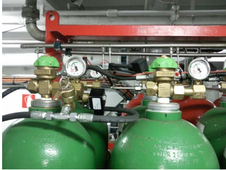
Figura 2-10 Batería de cilindros de agua presurizada con N2 a alta presión [8]
