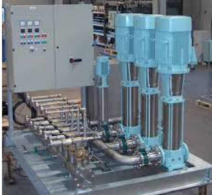
Figura 2-9 Grupo de bombeo con 6 válvulas de distribución a riesgos [8]
