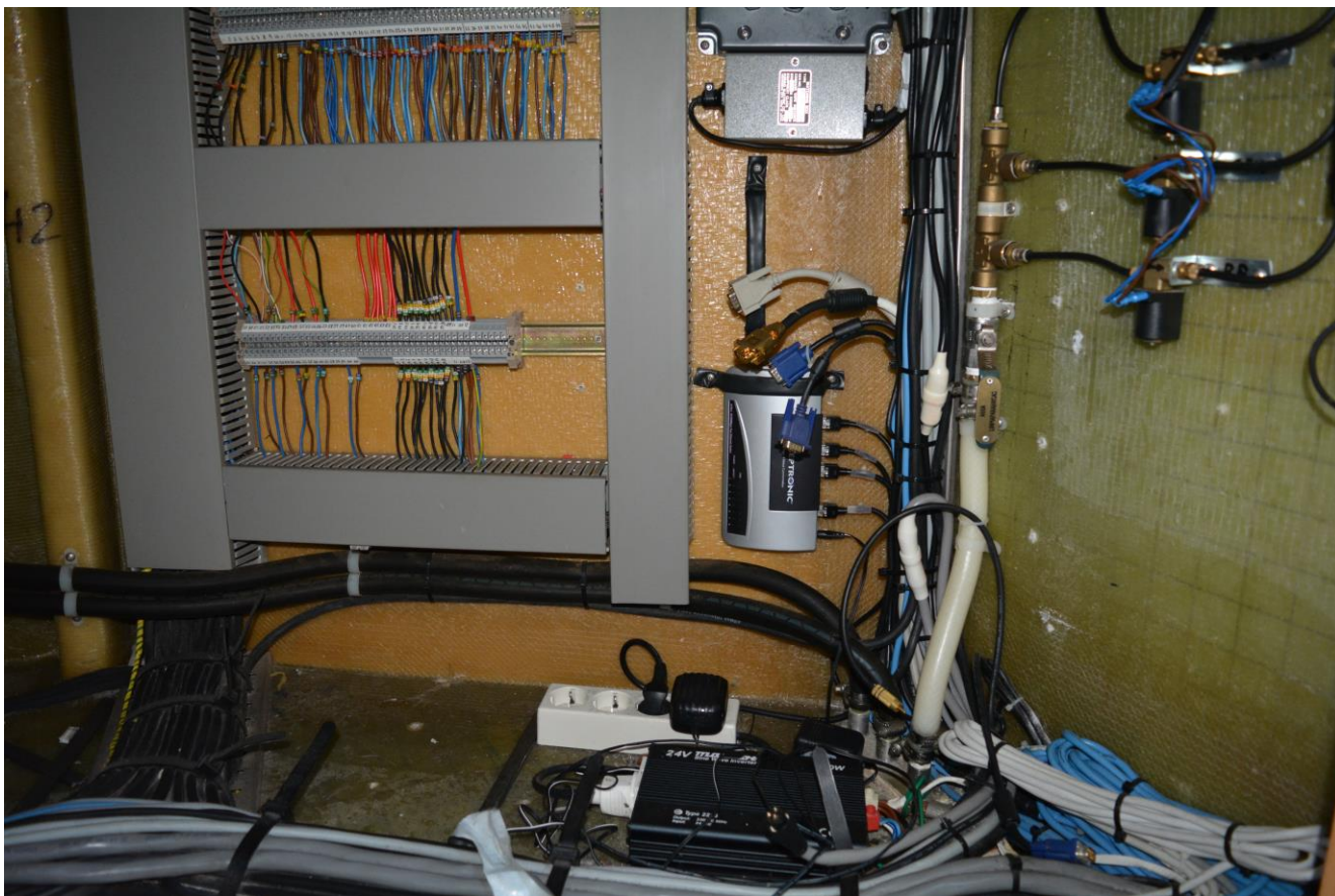
Figura A2-6 Armario de cableado.
