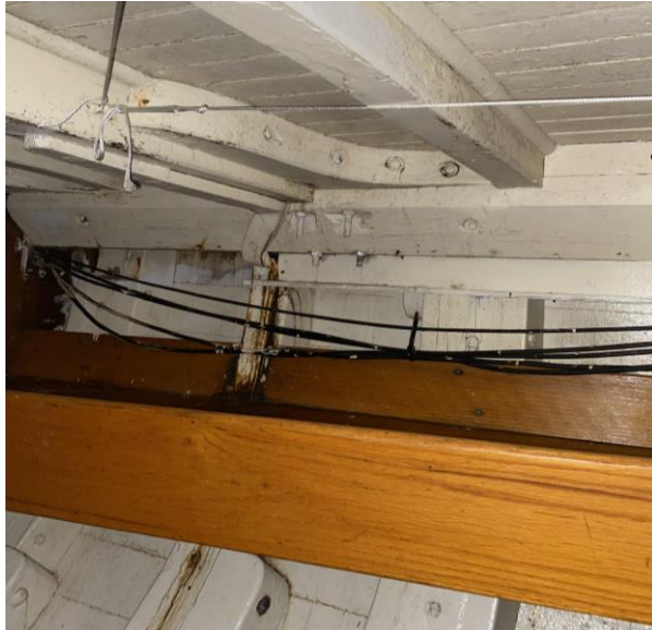
Figura 3-16 Filtración en el camarote de babor
