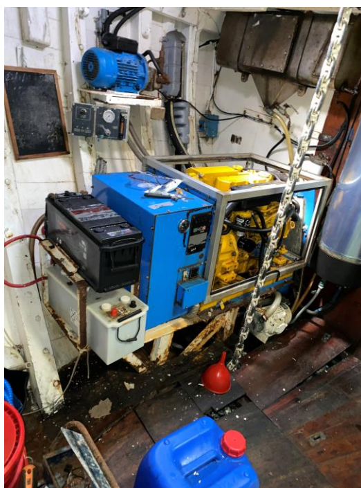
Figura 3-12 Generador situado en el pañol de contra maestre de proa
