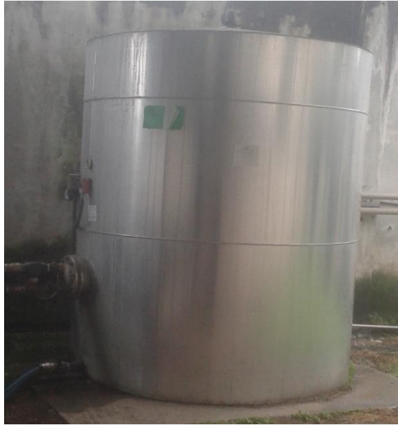
Figura 4-4: Acumulador de A.C.S. Fuente: Propia.
