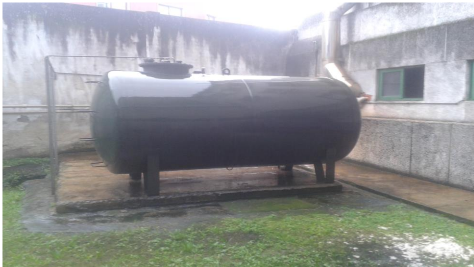
Figura 4-5: Depósito de combustible. Fuente: Propia
