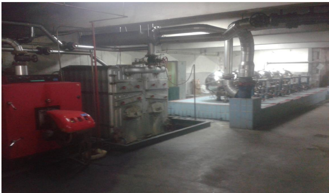
Figura 4-3: Sala de calderas del gimnasio GM Barrutia. Vista general. Fuente: Propia.
