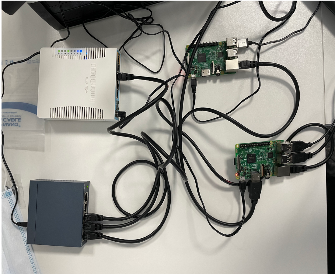
Figura 3-18 Maqueta construida en el laboratorio para la comprobación del protocolo DHCP (Autoría propia)
