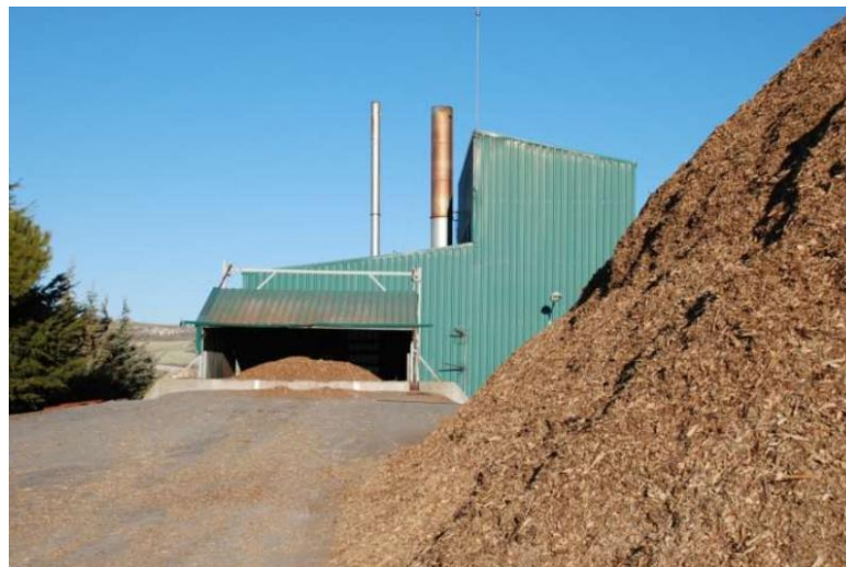
Figura 2-17 Central de calefacción y ACS de Cuéllar (Fuente: [58])
