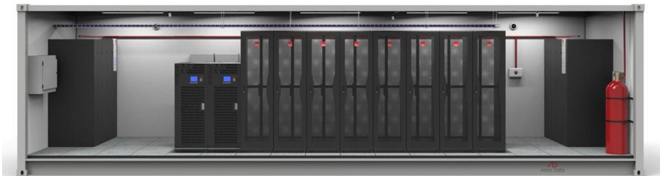
Figura 4-12 - CPDM de 8 racks y 10,2m (Fuente: Area Data Paraguay S.A.)
