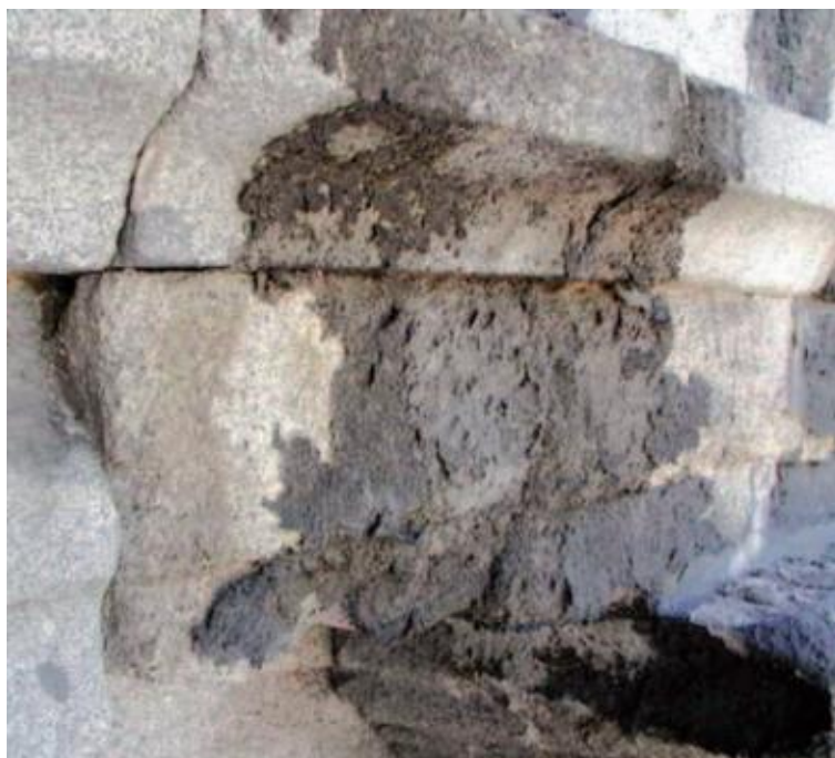
Figura 2-6 Costra negra de sulfatación en granito del Palacio Real. (Imagen extraída de [22])
