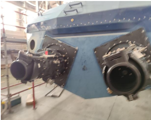
Imagen 11. Bocina de ejes de componentes mecánicos instalados en la popa de una embarcación de PRFV.
