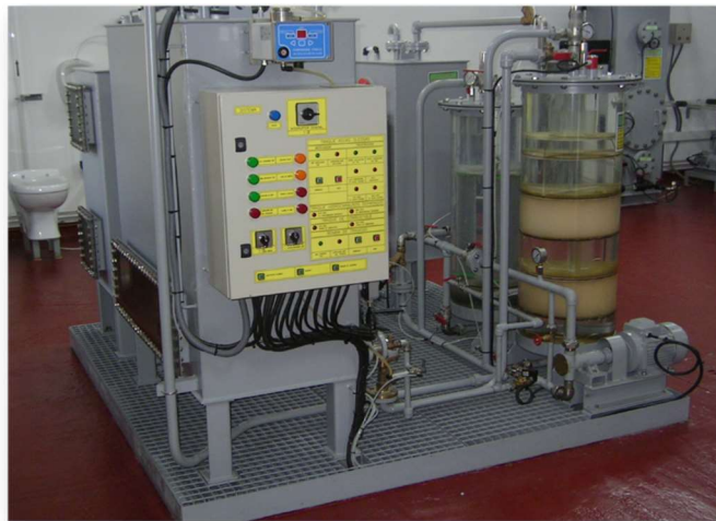
Figura 3-28 Separador de sentinas usado en fragatas F-100 [44].
