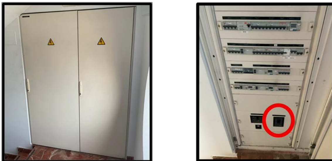
Figura 4-3 Cuadro eléctrico general situado en el primer tramo de las escaleras e interruptor de corte general de suministro eléctrico de todo el edificio.
