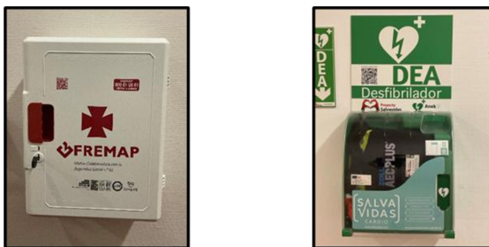
Figura 4-11 Botiquín situado en ambas plantas del edificio administrativo CUD-ENM (imagen de la izquierda) y DEA situado en la planta alta del edificio mencionado (imagen de la derecha).
