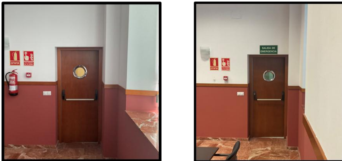
Figura 4-7 Salida de emergencia ubicada en el aula de grados antes y después de tener señalización de salida de emergencia
