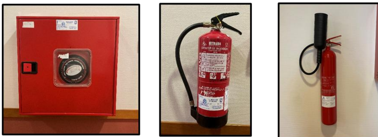
Figura 4-4 Medios de protección contra incendios. En la imagen de la izquierda una boca de incendio equipada (BIE). En la imagen central un extintor de 6 kg de polvo ABC y en la imagen de la derecha un extintor de 5 kg de CO 2 .
