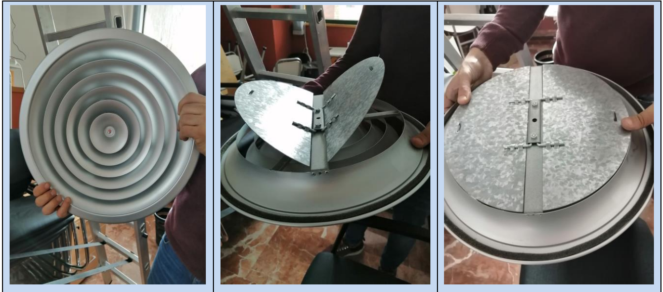
Figura 3-16 Rejilla de impulsión del Fancoil del despacho 112
