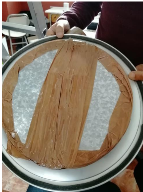
Figura 3-17 Aislamiento de fancoil despacho 112
