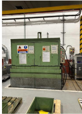
Figura A3 - 8 Estación de desengrasado en funcionamiento
