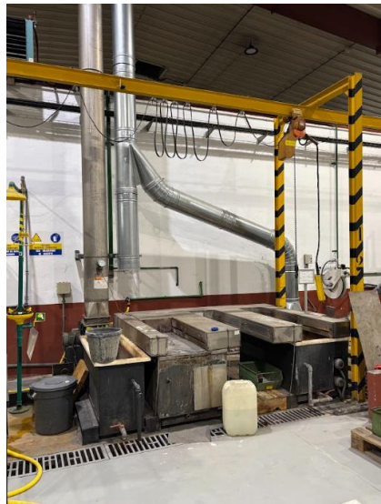
Figura A3 - 21 Estación pavonado, tanque agua caliente, tanque agua fría, tranque pavonado (de izquierda a derecha)
