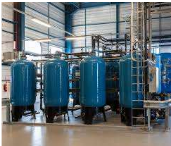
Figura 3-6 Sistemas de filtración industriales con tanque de fibra de vidrio [12]
