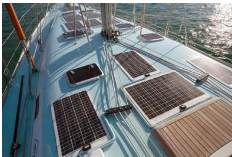
Figura 2-4 Instalación fotovoltaica en una embarcación de recreo ( www.solar-wind.co.uk )
