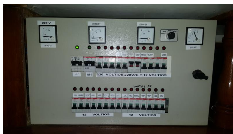
Figura 3-4 Cuadro de distribución principal del buque
