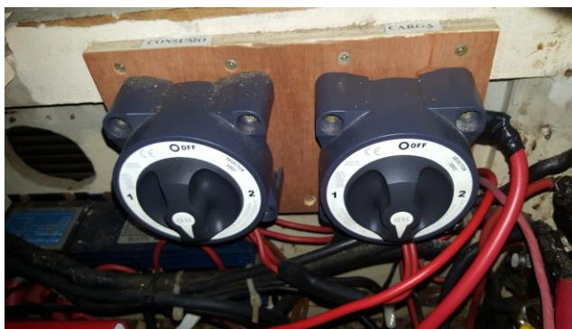
Figura 3-10 Selectores de carga de baterías
