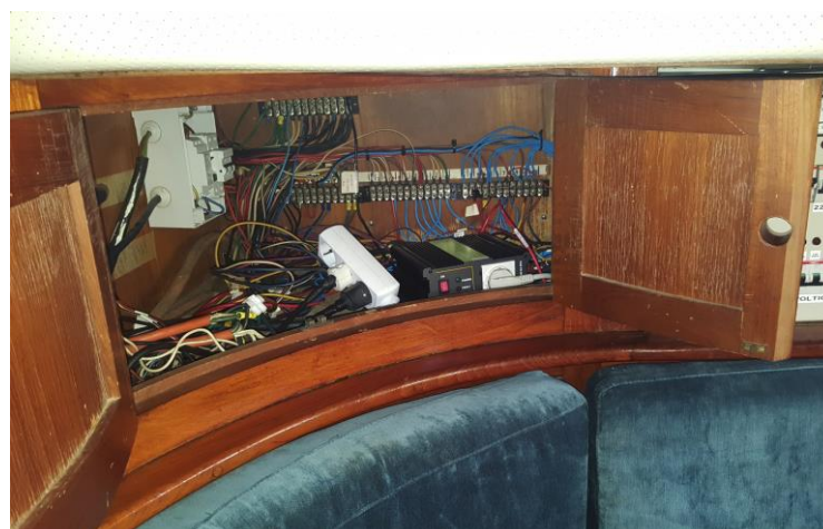
Figura 3-5 Inversor situado en el comedor-cocina
