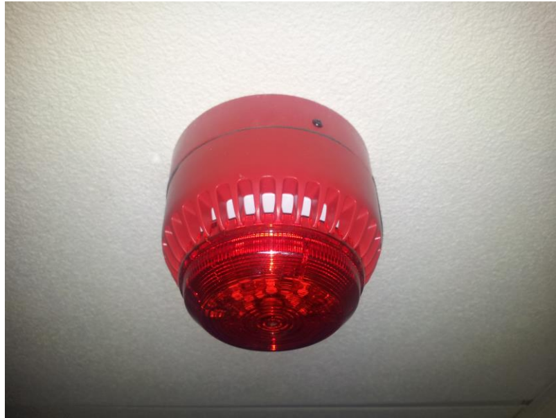
Figura 2-6 Iluminador de alarma
