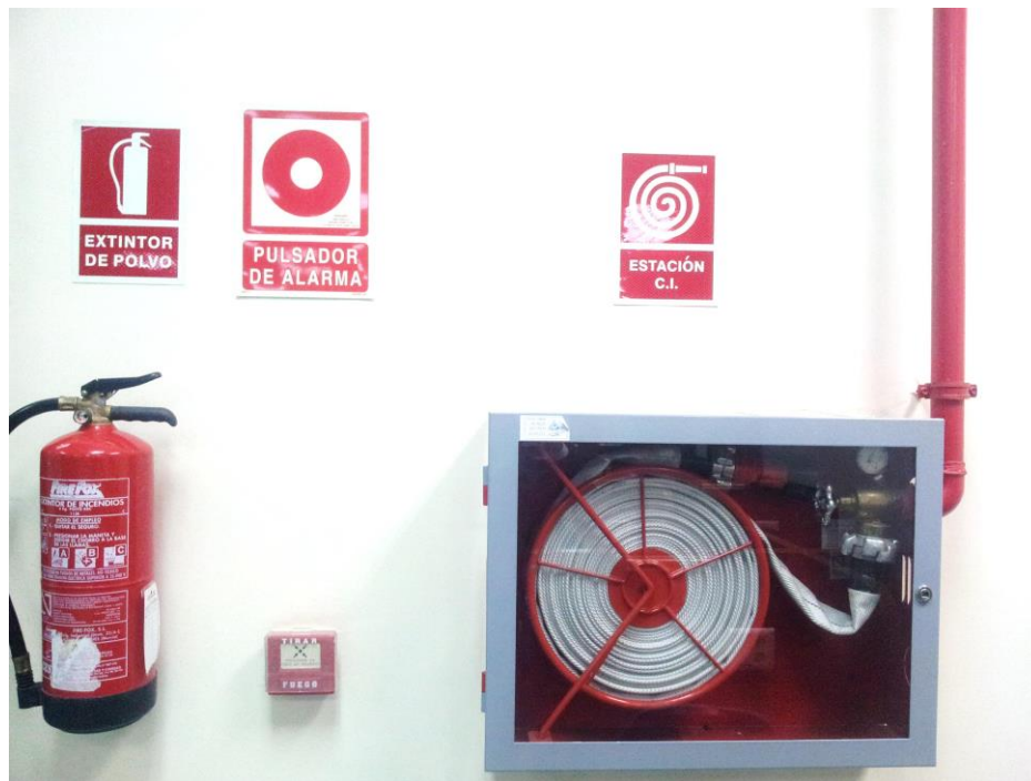
Figura 2-7 Extintor, pulsador y BIE
