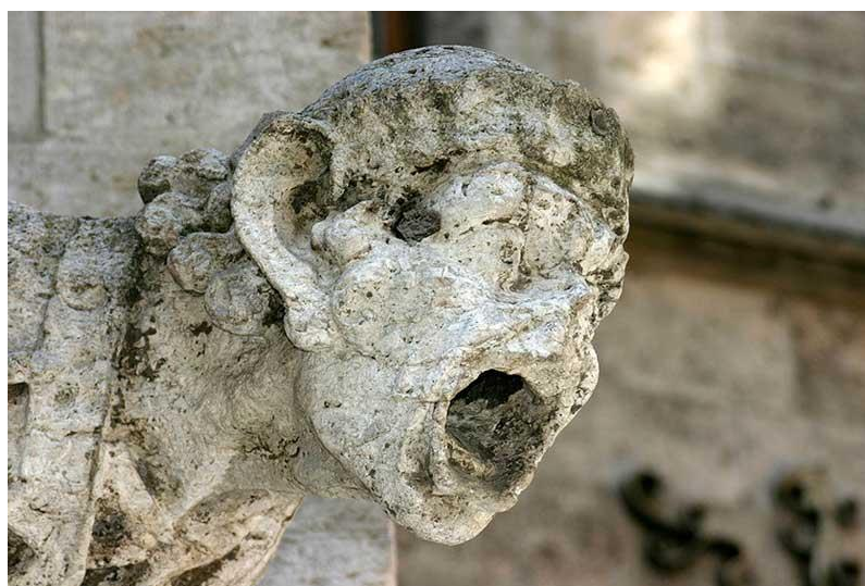
Figura 2-4. Gárgola dañada por la lluvia ácida [10]
