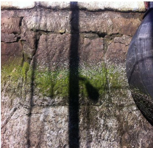
Figura 3-3: Muro del muelle con falta de juntas
