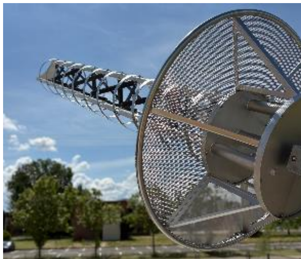
Figura 2-5: Antena satélite UHF en Estación de Anclaje de Torrejón de Ardoz con polarización circular.
