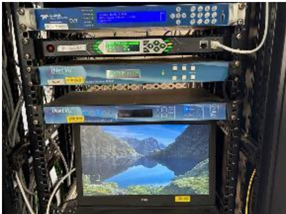
Figura 2-18: Ejemplo de rack satélite instalado en las Islas Chafarinas.
