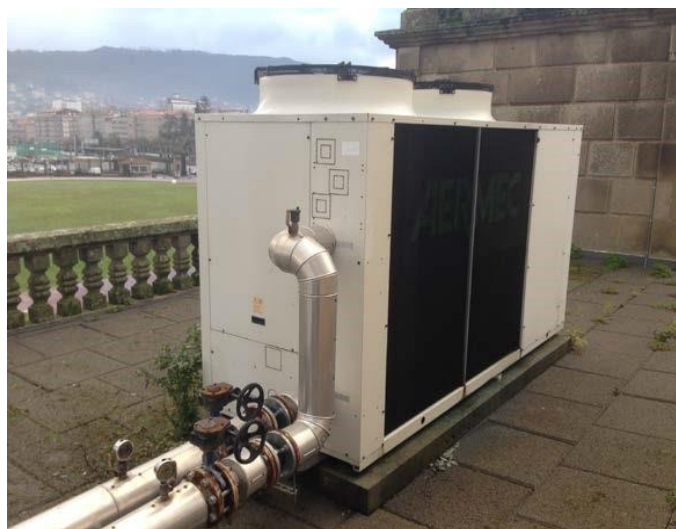
Figura 3-4 Bomba de calor aire-agua del edificio
