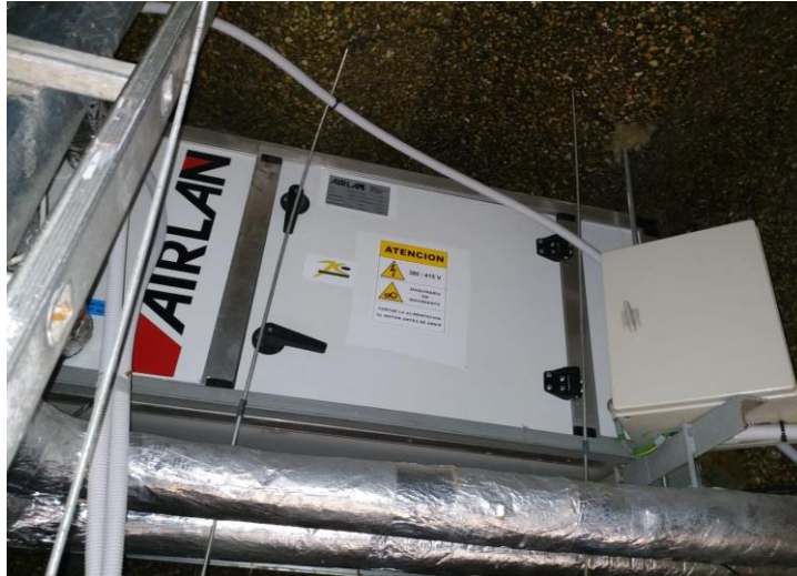
Figura 3-11 Unidad de tratamiento del aire AIRLAN FM-36
