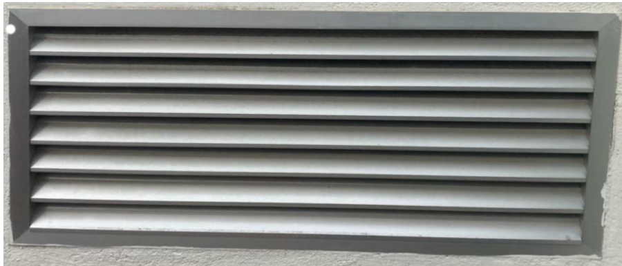
Figura 3-36 Entrada de aire a la UTA de la primera planta
