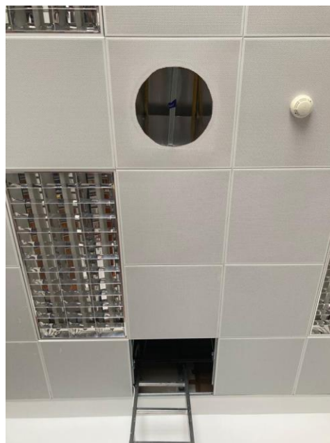
Figura 3-32 Difusor de aire retirado
