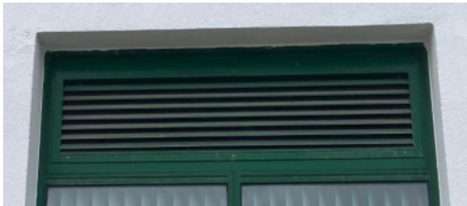
Figura 3-37 Entrada de aire a la UTA de la planta baja
