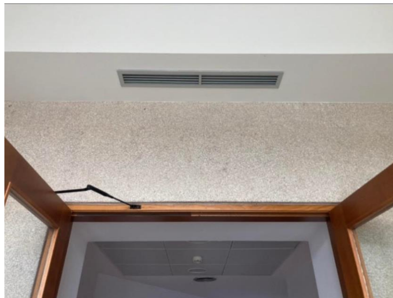
Figura 3-15 Difusor lineal ubicado al final del pasillo central
