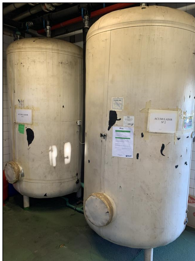
Figura 3-6 Sala de Calderas. Acumuladores.
