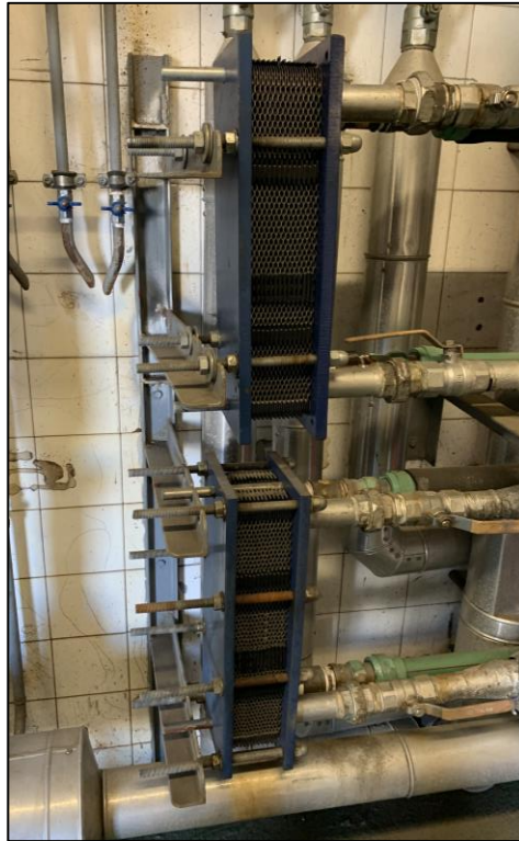
Figura 3-7 Sala de Calderas. Intercambiadores de calor.
