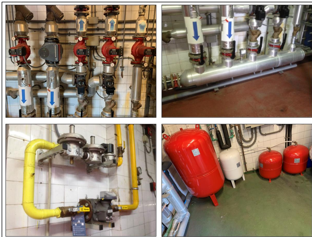
Figura 3–9 Sala de Calderas. Componentes. Bombas de impulsión (arriba izq), colectores (arriba dcha), grupo de presión (abajo izq), vasos de expansión cerrados (abajo dcha).
