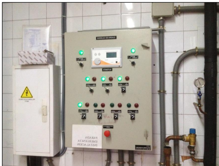
Figura 3-8 Sala de Calderas. Grupo de control.
