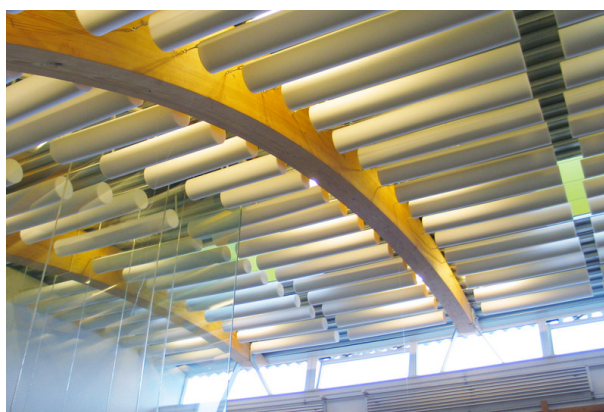
Figura 2-18 Techo con baffles fonoabsorbentes [9]
