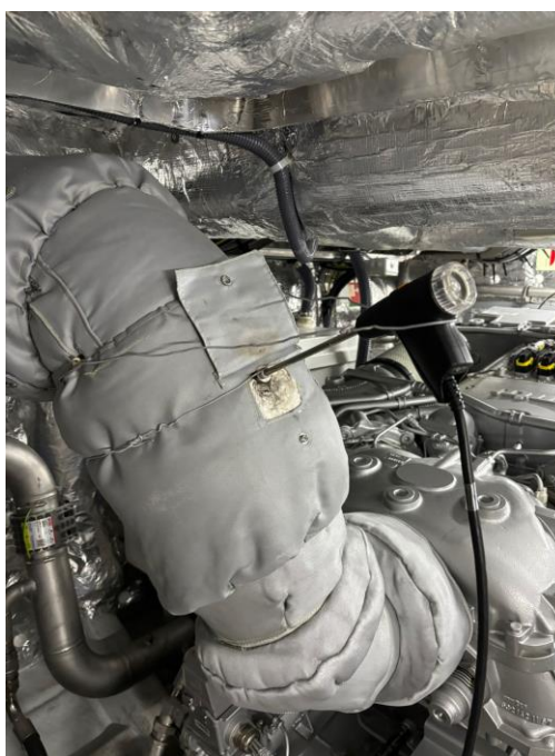
Figura 3-6 Codo gases de escape de la GM Godínez (fuente propia)
