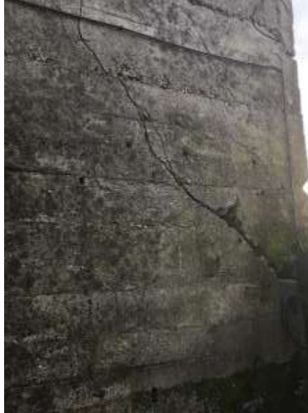
Figura 4-3 Desperfecto originado en el muro norte. (Elaboración propia)
