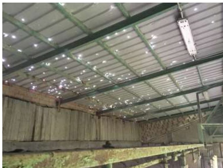
Figura 4-6 Techado de la zona de blancos agujereado por impactos. (Elaboración propia)
