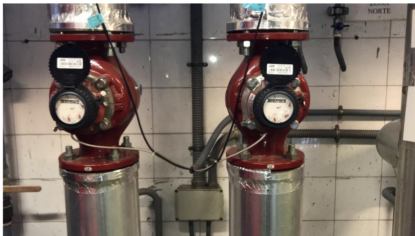
Figura 5-12. Caudalímetros. Elaboración propia
