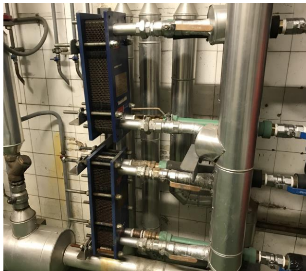
Figura 5-8. Intercambiadores de calor de placa. Elaboración propia
