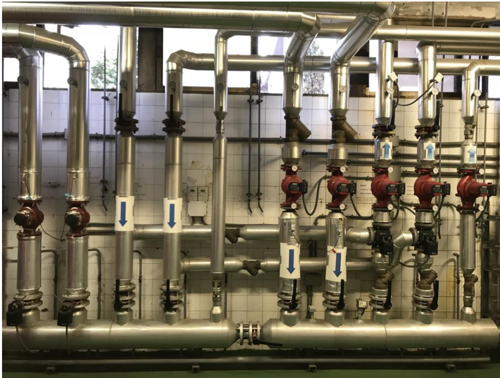
Figura 1-1. Instalación a monitorizar. Elaboración propia
