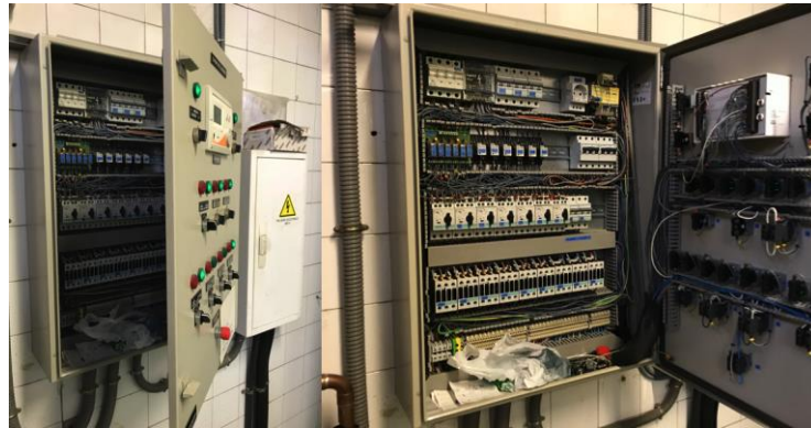
Figura 5-10. Cuadro de control de instalaciones térmicas Fco Moreno. Elaboración propia
