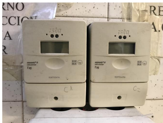
Figura 5-13. Contadores de la instalación. Elaboración propia
