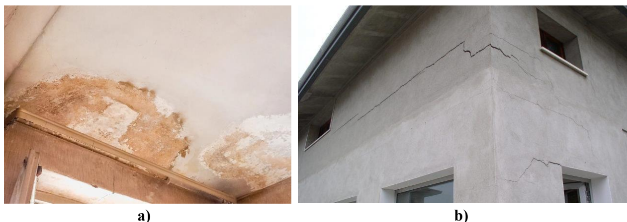
Figura 2-2 Patologías en los edificios: a) Humedad, b) Grieta (Extraído de: a) [13], b) [14])
