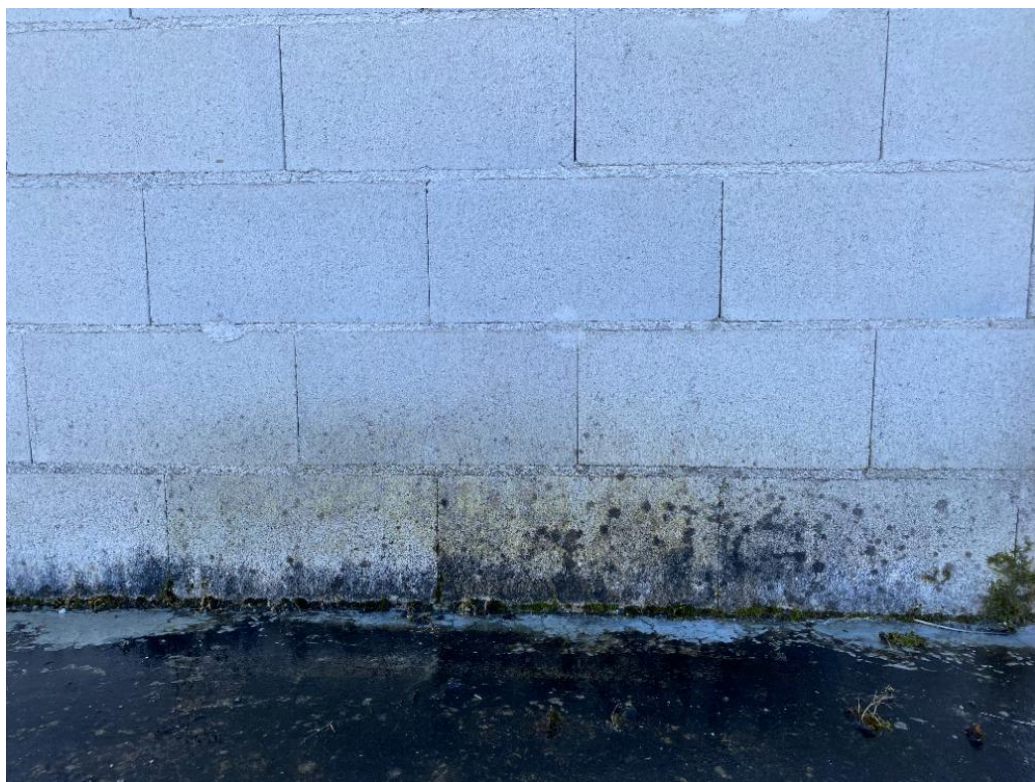
Figura 2-1. Humedad por penetración directa en el CASI de la ENM (Fuente: propia).
