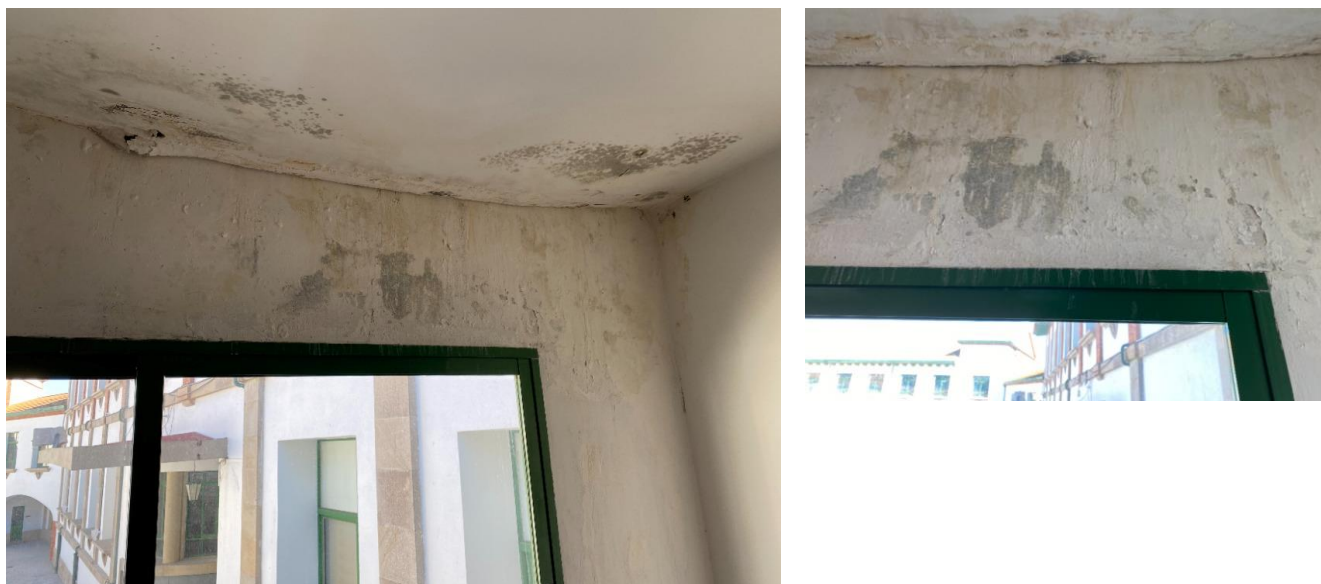
Figura 2-2. Humedades por condensación en el aula 8 de la ENM (Fuente: propia).
