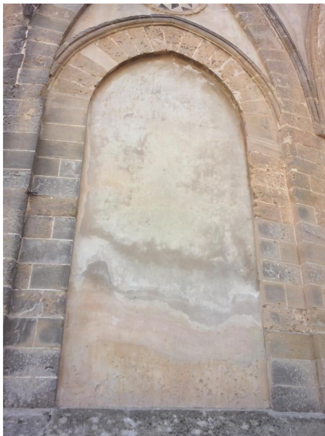
Figura 2-3. Mancha de humedad asociada a la absorción de agua por parte de las sales solubles (compuestos higroscópicos) en iglesia de Cádiz (Fuente: propia).
