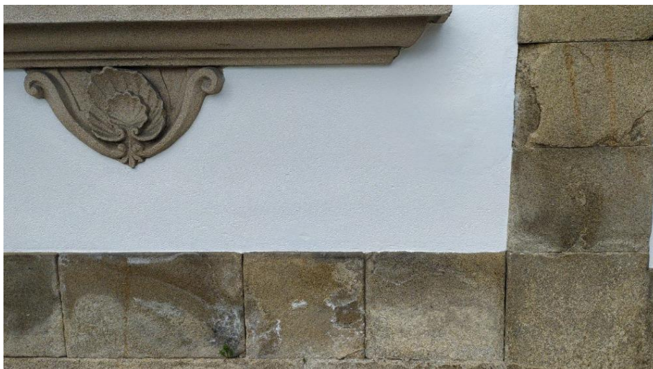
Figura 2-8. Cristalización de sales solubles en pared cercana al puesto de correos de la ENM (Fuente: propia).
