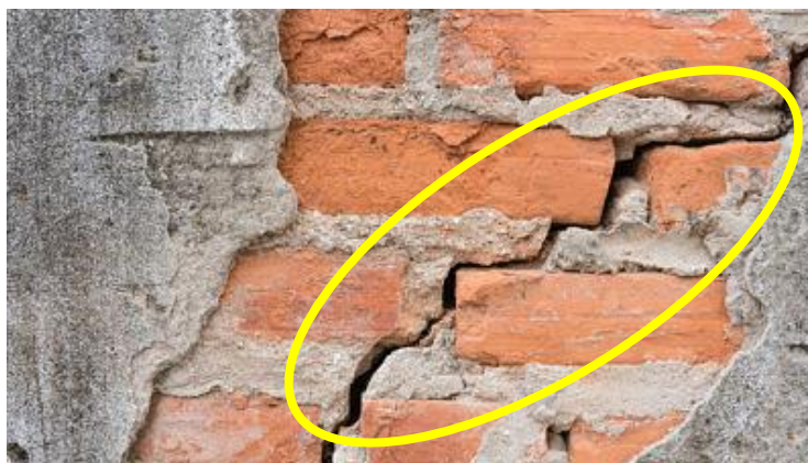
Figura 2-6. Deterioro de fachada por expansión hídrica [13].
