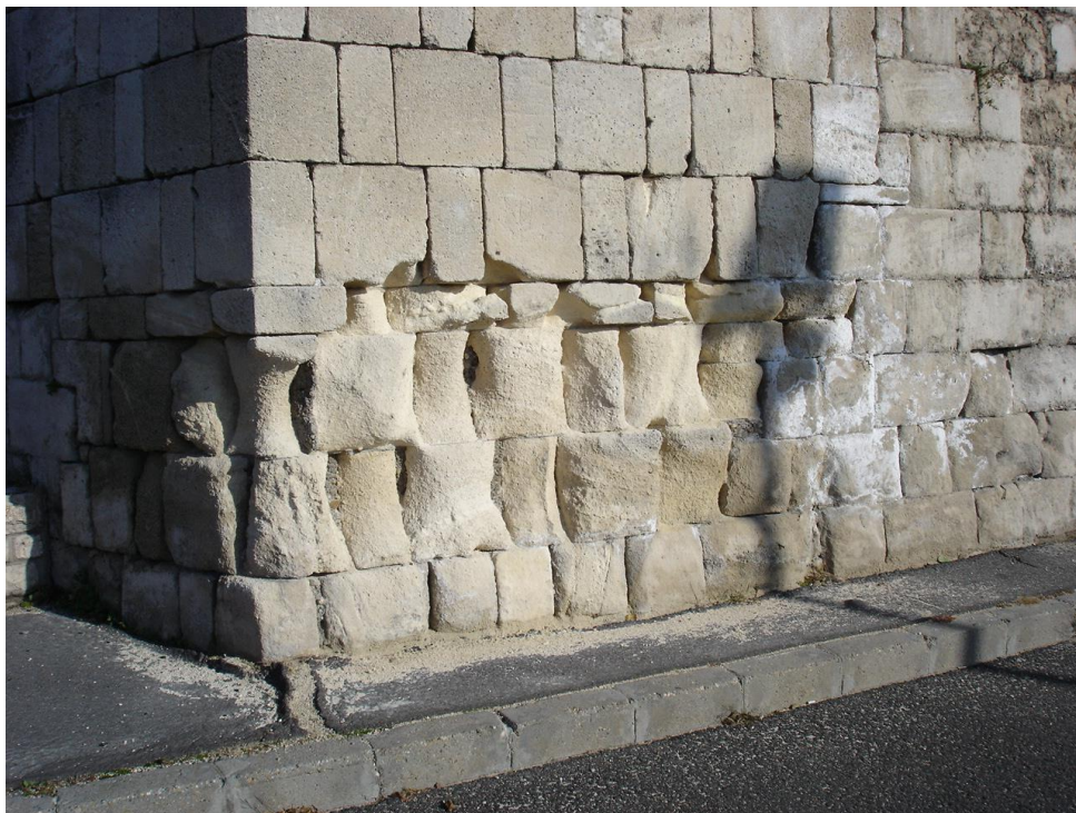
Figura 2-7. Daños causados por sales solubles en muro del centro de Cádiz (Fuente: propia).
