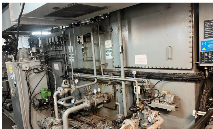
Figura 1-1 Planta de Tratamiento de Aguas Residuales del Buque de Aprovisionamiento en Combate BAC A-15 “Cantabria” (elaboración propia)
