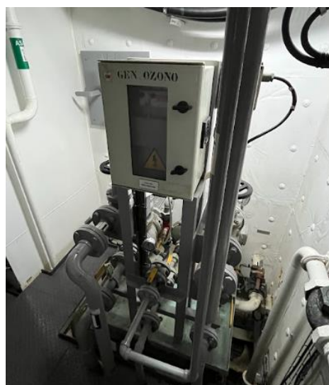
Figura 2-5 Generador de Ozono buque F-105 (elaboración propia)
