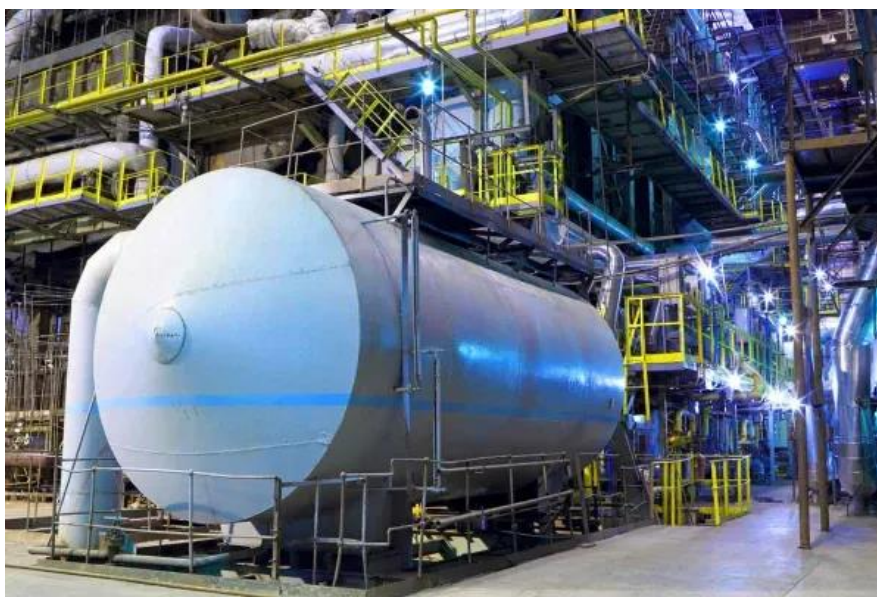
Figura 2-5 Tanque de hidrógeno de alta presión en una planta química [14]
