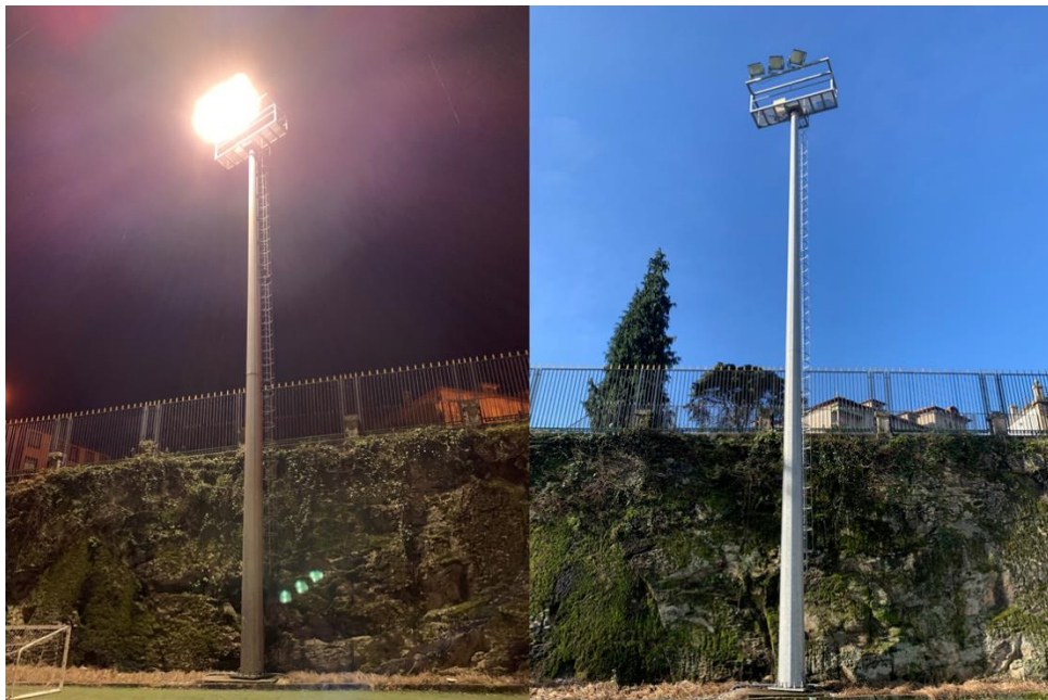
Figura 1-3 Instalación y funcionamiento de iluminación actual
