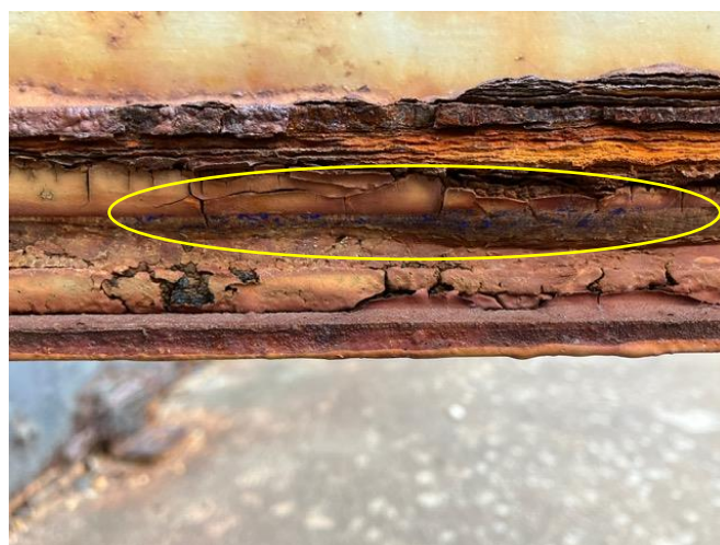
Figura 3-23: Junta de goma de la puerta con marcas de pintura azul. (Elaboración propia).
