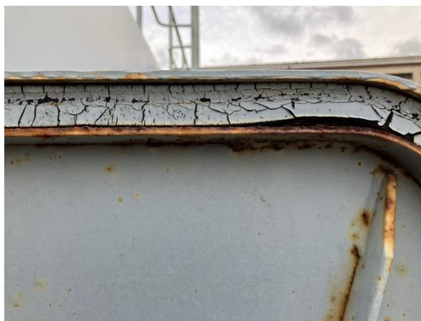
Figura 3-21: Goma dañada de la puerta estanca. (Elaboración propia).
