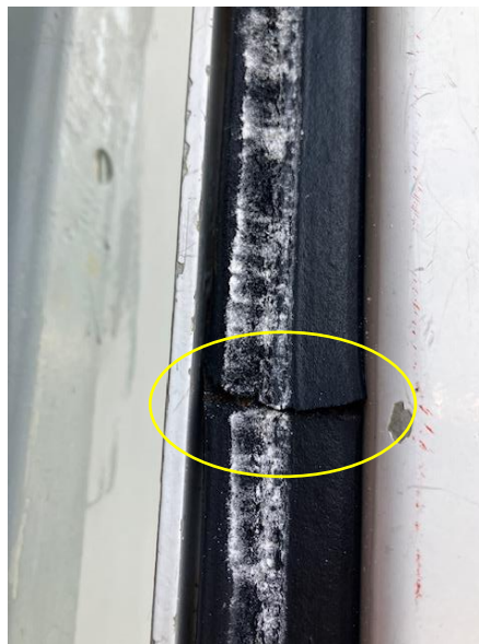
Figura 3-37: Burlete dañado de la puerta estanca. (Elaboración propia).
