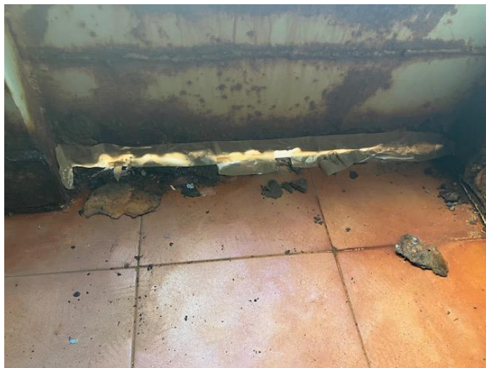
Figura 3-18: Grieta taponada con cinta americana. (Elaboración propia).
