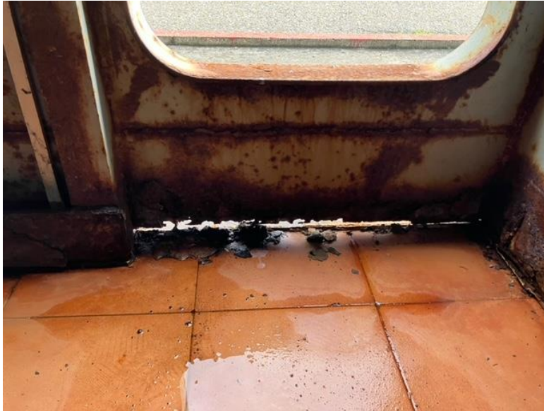
Figura 3-17: Grieta de la parte inferior del mamparo. (Elaboración propia).
