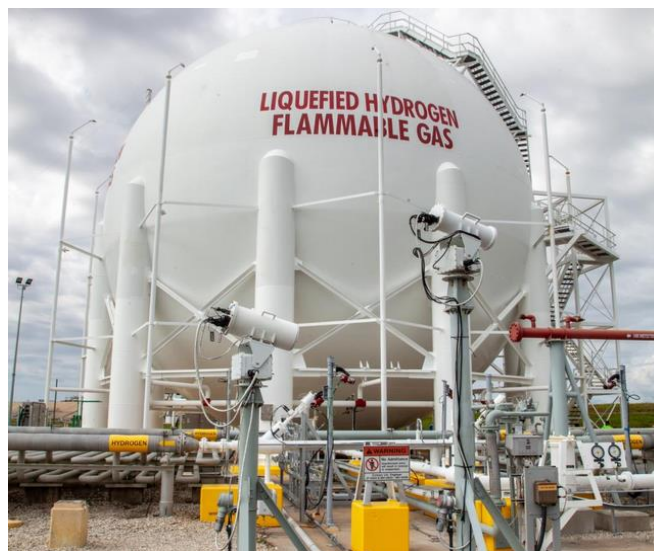
Figura 2-6: Depósito criogénico de hidrógeno líquido con sistemas de aislamiento térmico para la reducción del fenómeno de boil-off. Fuente: [Wikimedia Commons].
