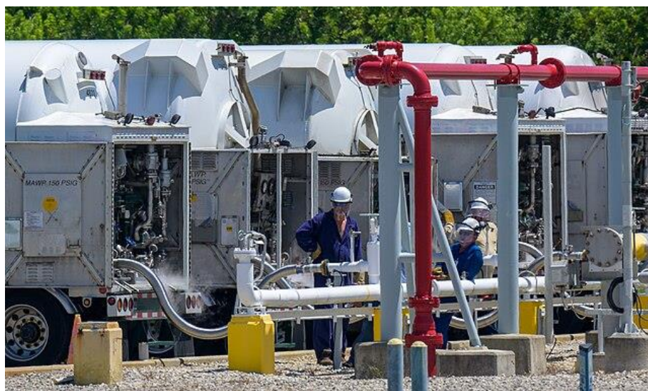
Figura 2-3: Instalación industrial asociada al almacenamiento y manejo de hidrógeno, representativa de la infraestructura técnica y de las inversiones necesarias para el desarrollo de esta cadena de valor energética. Fuente: [Wikimedia Commons]
