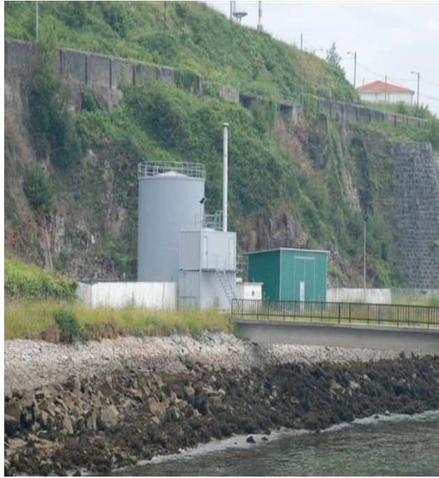
Figura 2-5.- Planta de tratamiento de aguas oleosas in situ de DETEGASA, Ferrol, imagen tomada de [16]
