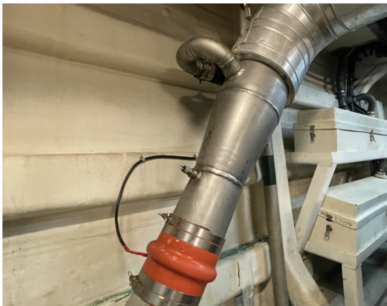
Figura 3-19 Conducto de escape de gases en L.I. GM Salas (fuente propia)
