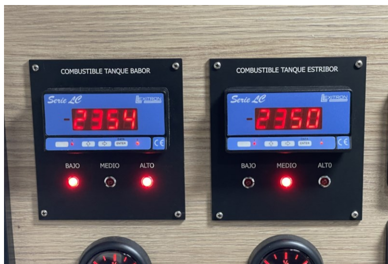
Figura 3-10 Indicadores de nivel de los dos tanques de L.I. GM Godínez (fuente propia)
