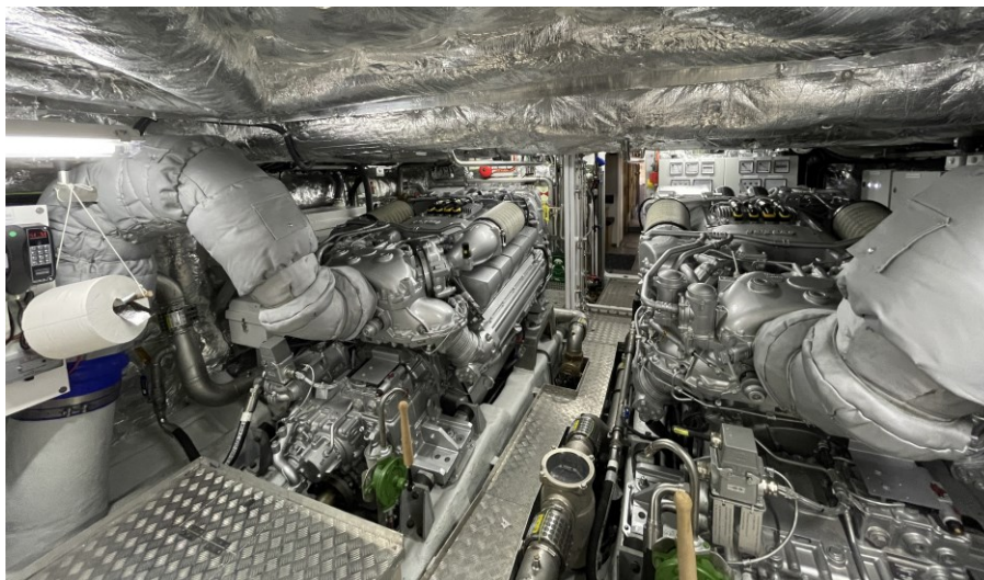
Figura 3-11 Cámara de máquinas L.I. GM Godínez (fuente propia)
