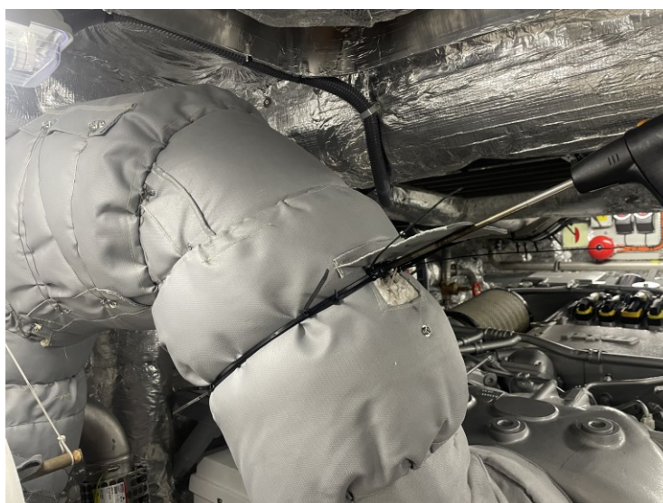
Figura 3-22 Sistema de sujeción del analizador de gases en la medición de la L.I. GM Godínez (fuente propia)
