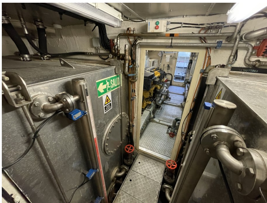
Figura 3-5 Compartimento de tanques de combustible (fuente propia)
