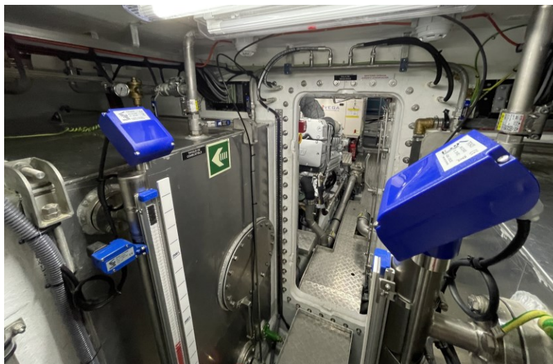
Figura 3-9 Compartimento de tanques de combustibles de L.I. GM Godínez (fuente propia)
