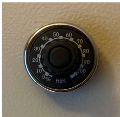
Figura 3-13 Controlador del régimen de velocidad de la UTA.
