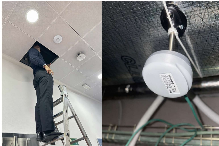
Figura 4-11 Instalación de la sonda 2 en el pasillo de la plana baja del CUD.
