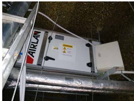
Figura 3-8 Unidad de Tratamiento del Aire FMA/HP 036, instalada en el CUD [10].
