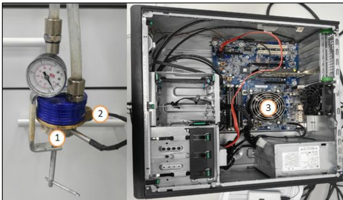
Figura 3-3 Elementos a refrigerar.
