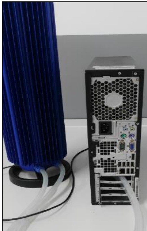
Figura 3-34 Vista general durante el ensayo realizado sobre la CPU utilizando el fluido Novec ® 7000.
