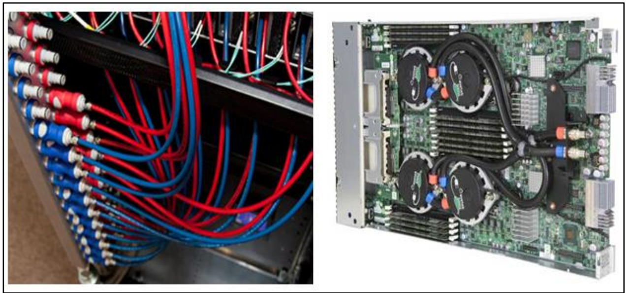
Figura 5-6 Ejemplos de tomas de conexiones de los elementos electrónicos al fluido Novec así como del fluido Novec a los conductos comunes en estado gaseoso y estado líquido del fluido [51] [52].
