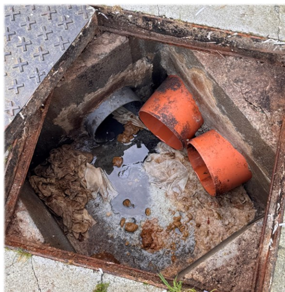
Figura 3-8. Acumulación de materiales textiles y sólidos gruesos en la arqueta previa al pozo de bombeo.
