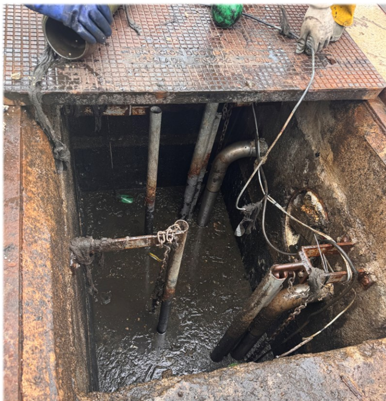
Figura 3-9. Estado del pozo de bombeo durante intervención por obstrucción.
