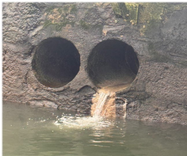
Figura 3-2. Punto de descarga del vertido en el margen oeste de la dársena.
