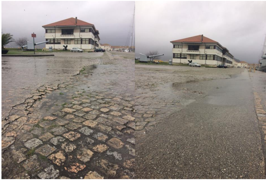
Figura 4-3 Estado de la calzada en los alrededores del Isaac Peral
