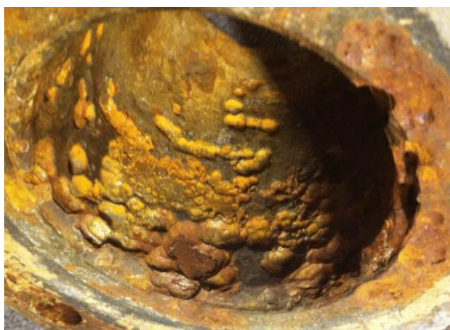
Figura 2-3 Corrosión biológica en una tubería [8]
