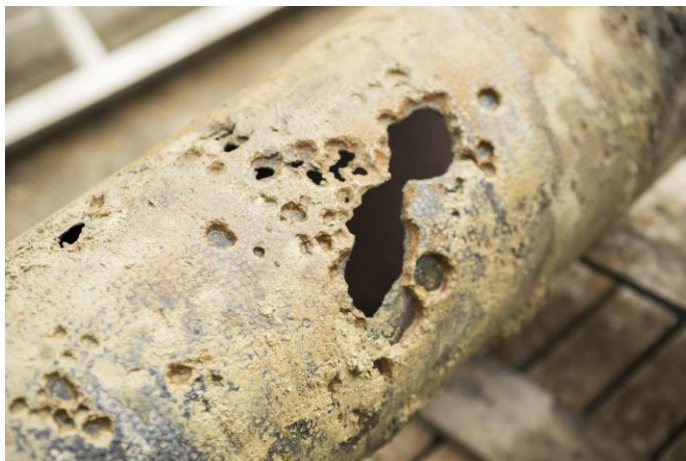
Figura 2-2 Corrosión por picadura en una tubería [6]
