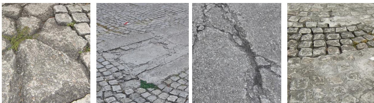
Figura 1-1 Deterioro de la zona de estudio presentando diversas patologías
