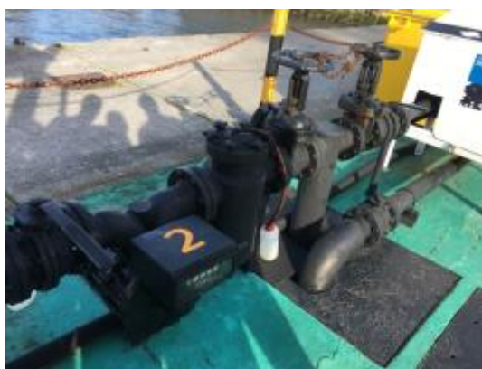
Figura 3-13 Ejemplo de filtro de gasóleo en surtidor
