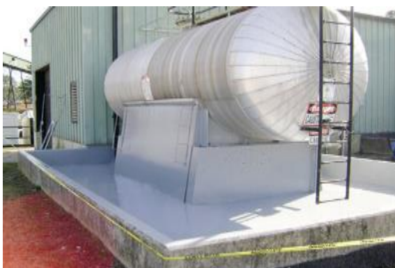
Figura 1-11 Depósito atmosférico con cubeto de retención [27]
