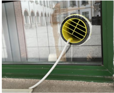
Figura 3-6 Salida del aire contaminado al exterior
