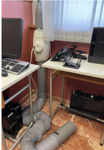
Figura 3-5 Tubo extractor de aire contaminado en el interior del Despacho 114
