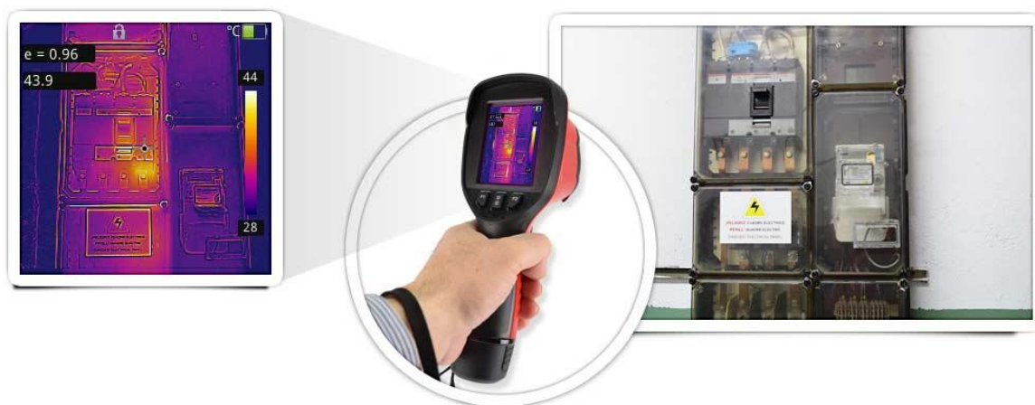
Figura 2.7 Imagen de un cuadro eléctrico en el espectro infrarrojo tomada con la cámara termográfica modelo IR-282 [23]
