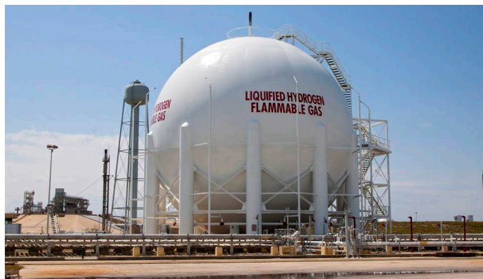
Figura 2-7. Tanques esféricos de hidrógeno licuado [51]
