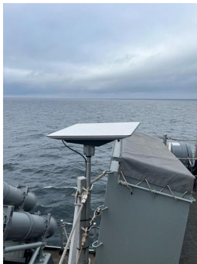
Figura 31.- Instalación antena Starlink en la fragata “Cristóbal Colón”. Fuente: Personal destino de la Radio del buque. [10]
