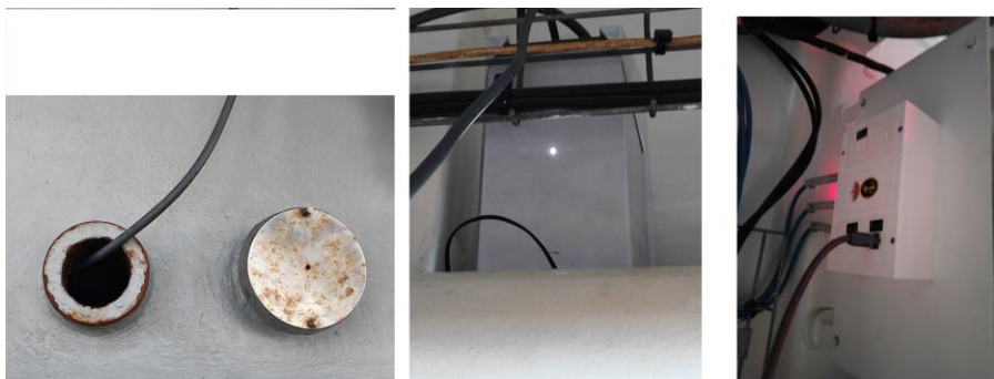
Figura 33.- Instalación en local Radio Principal del Sistema Starlink en la fragata “Cristóbal Colón”. Fuente: Personal destino de la Radio del buque. [10]
