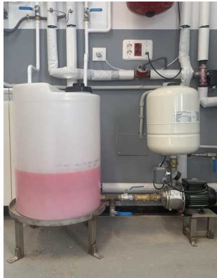
Figura 4-15 Depósito fluido calor-portante
