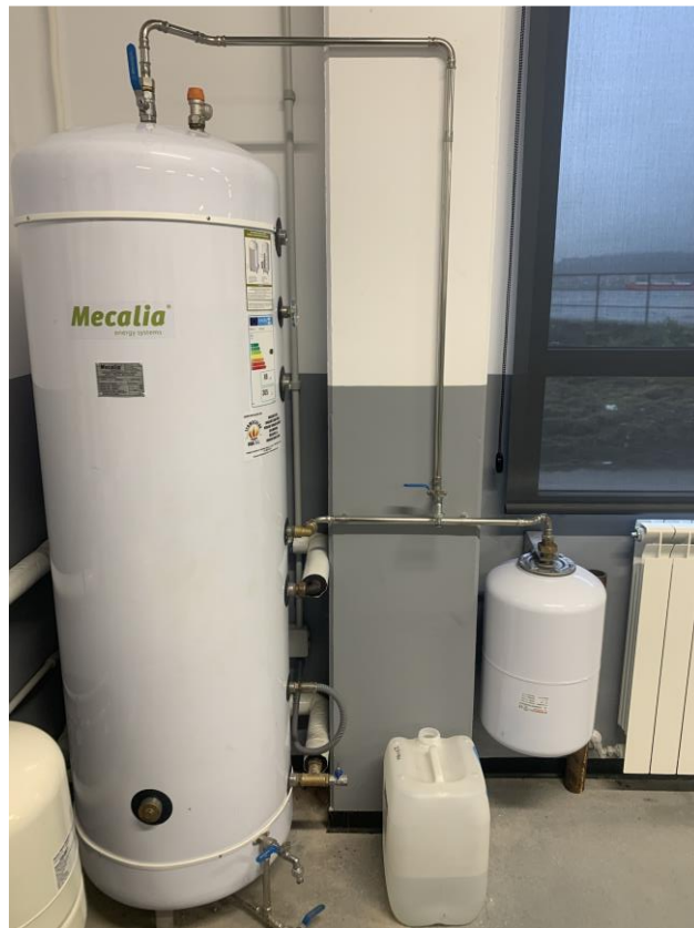
Figura 4-8 Interacumulador de la instalación
