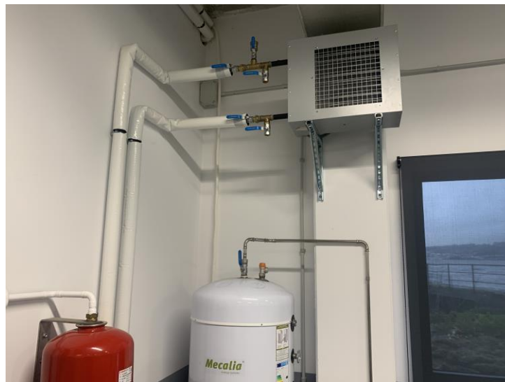
Figura 4-12 Aerodisipador de la instalación
