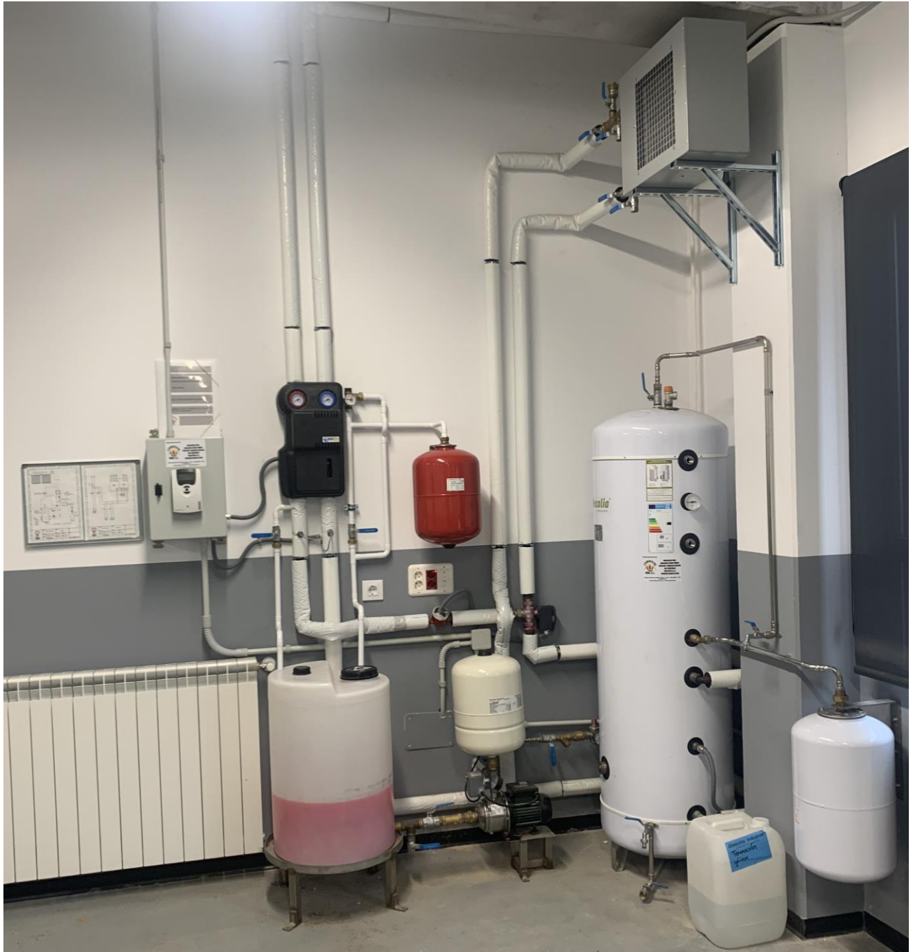
Figura 4-4 Conjunto de componentes que conforman la instalación solar
