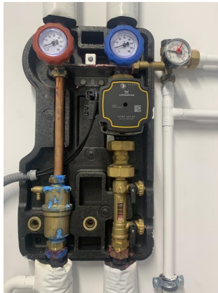
Figura 4-13 Grupo hidráulico de la instalación
