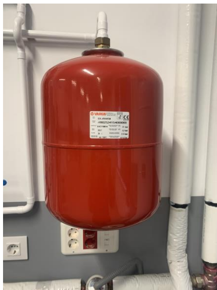
Figura 4-10 Vaso de expansión conectado al grupo hidráulico
