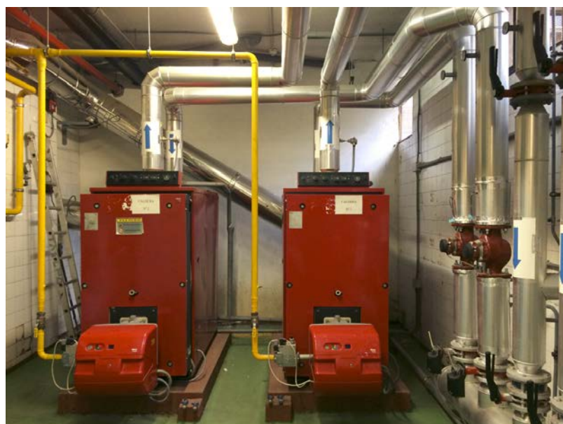
Figura 5-7 Detalle calderas Roca BT 450 y quemadores BAXI TECNO 50 Fuente elaboración propia
