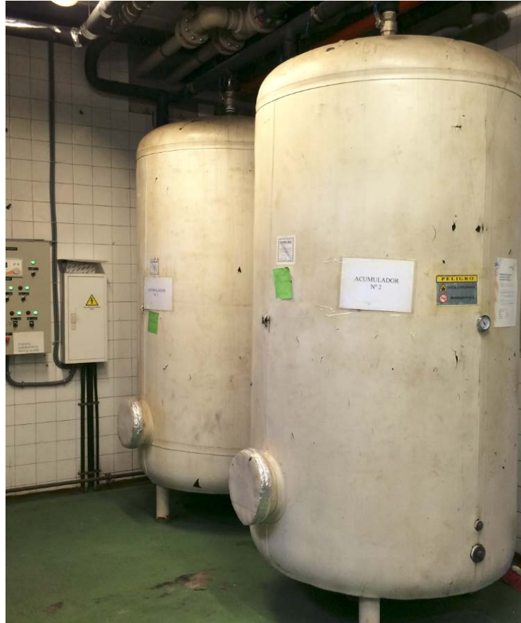
Figura 5-10 Detalle Acumuladores de 3000 litros en la sala de calderas del Francisco Moreno Fuente elaboración propia
