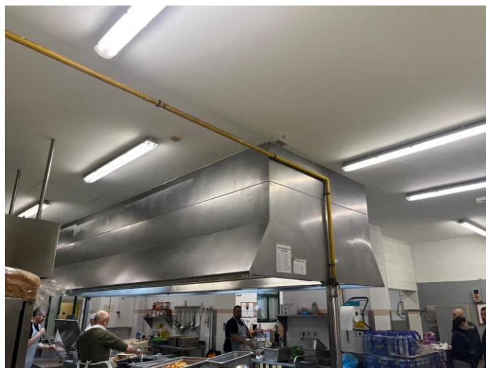
Figura 3-31 Fuentes de iluminación de la cocina.
